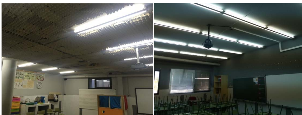
Imagen 6. Luminarias instaladas en el interior del centro
