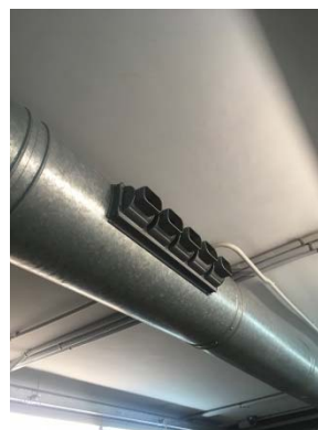
Imagen 11. Unidades terminales en forma de toberas
