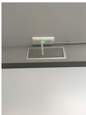
Imagen 10. Unidades terminales en forma de rejillas
